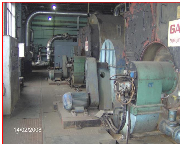
Slika 4. Prikaz radnog mesta u kotlarnici
